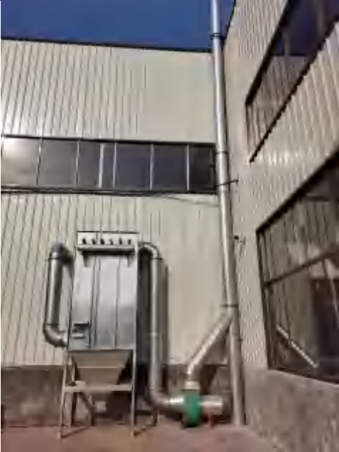
熔化废气处理设备
