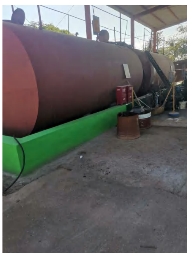
废润滑油储罐区
