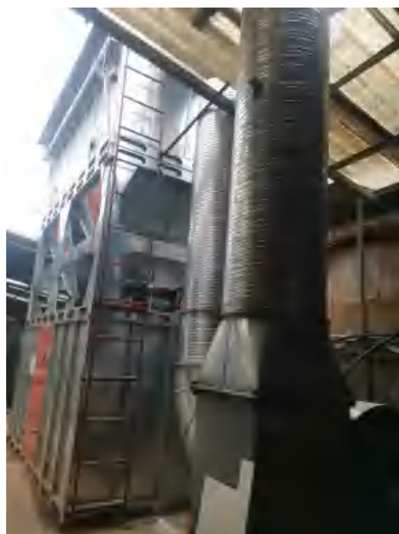
废气处理设施照片
