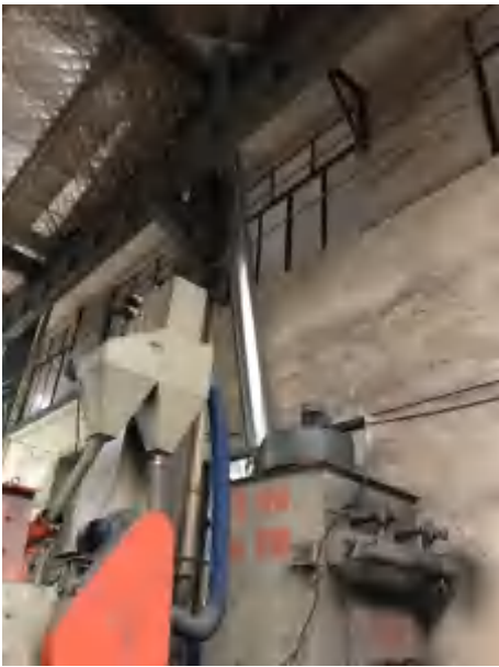
抛丸废气处理设备
