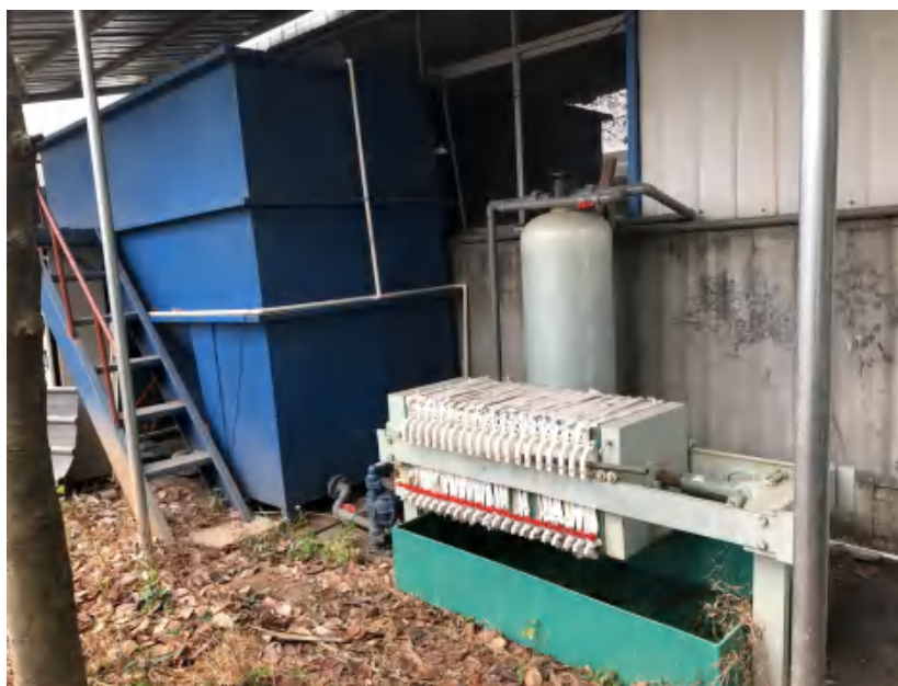
污水处理系统
