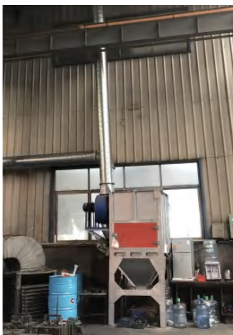
熔化废气处理设备
