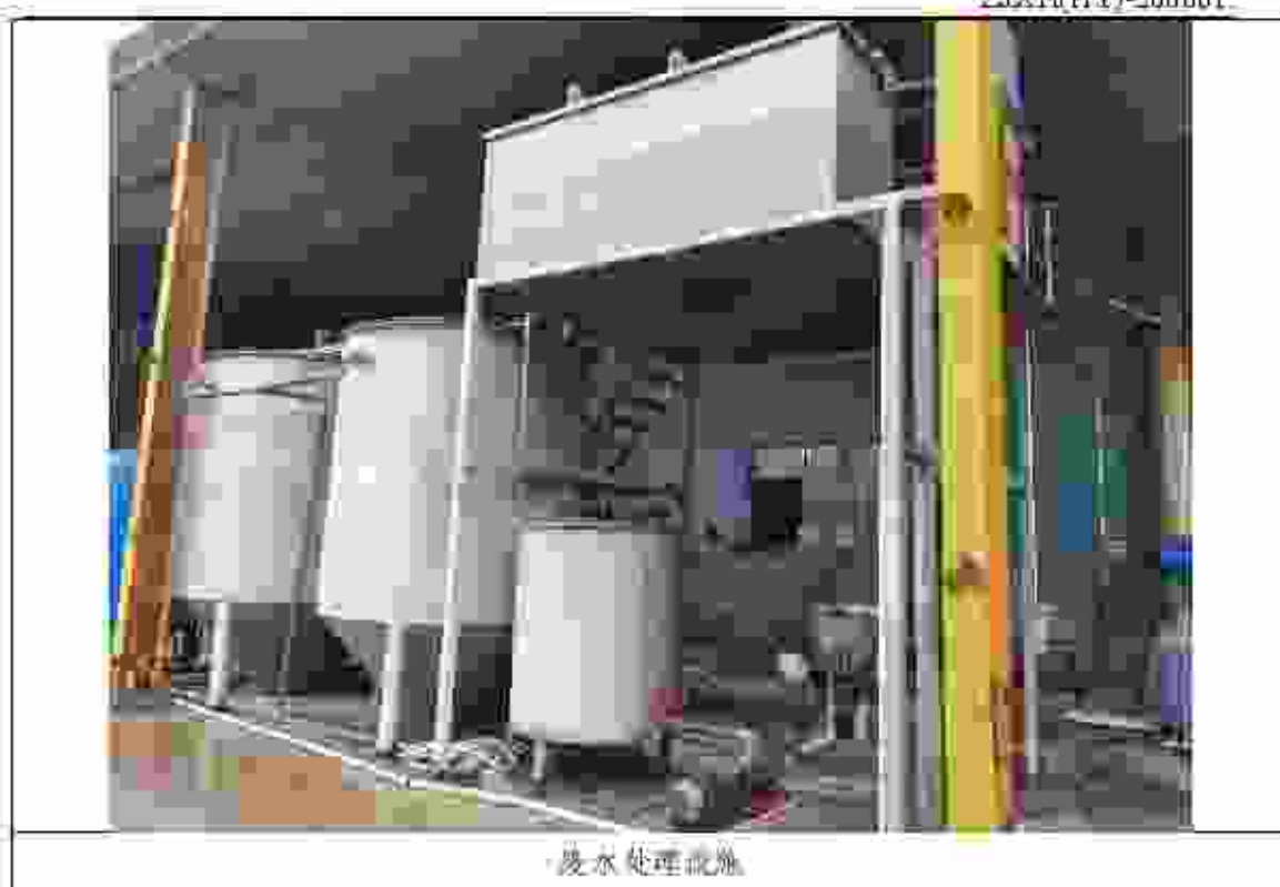
图 4-2 废水处理设施图片
