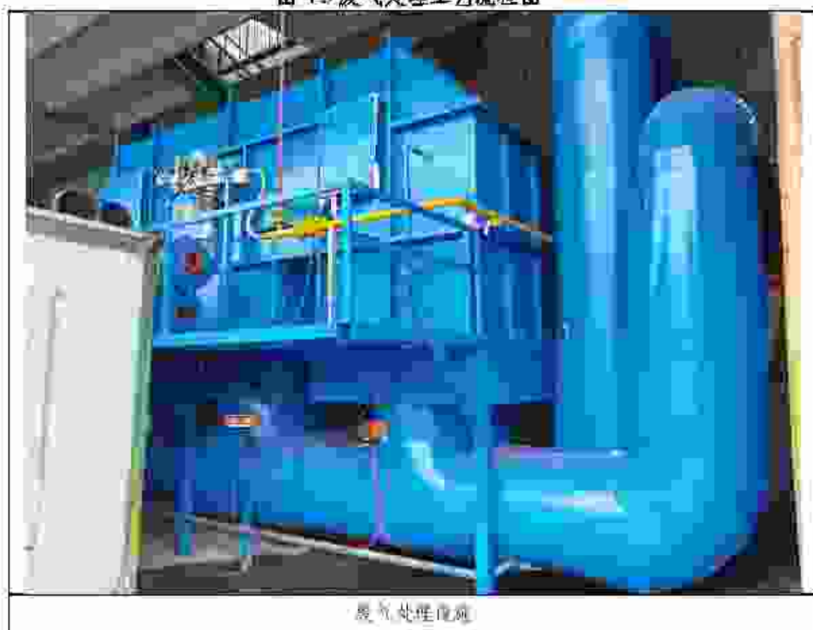
图 4.4 废气处理设施照片
