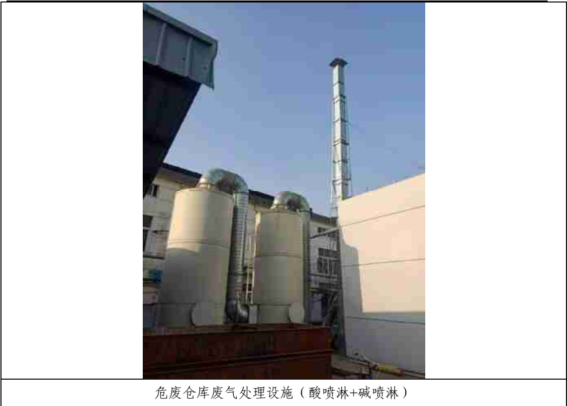
图 4-3 废气处理设施图片
