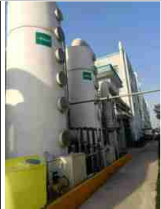
污水站废气处理设施（水喷淋+碱喷淋）
